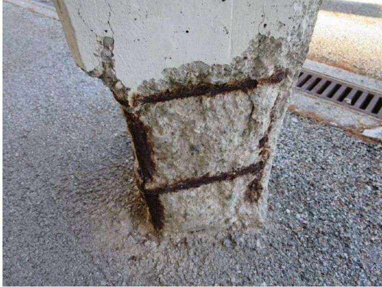
Şekil 2.9.4 Bodrum kat kolonlarında nem ve rutubetten dolayı beton örtüsünün bozulması ve paslanmanın meydana gelmesi
