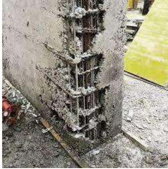
Şekil 2.2.3 şantiyede vibratörün yanlış kullanımı veya kullanılmaması sonucu oluşan Segregasyon
