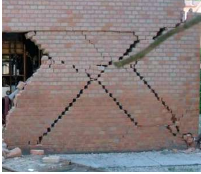
Şekil 2.8.11 Düşük dayanımlı harç nedeniyle yığma duvarda oluşan diyagonal kesme çatlakları.
