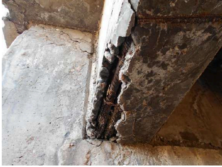
Şekil 2.9.2 Beton örtüsünün dökülmesi sonucu donatının çevresel etkilere açık hale gelmesi.,
