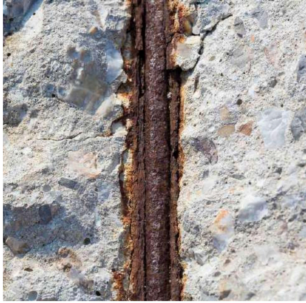
Şekil 2.9.1 Paslanan demirin hacminin 4 ila 6 kat genişleyerek içsel basınç oluşturmamasını, beton kabuğunun çatlatmasını ve en sonunda paspayının tamamen dökülmesi
