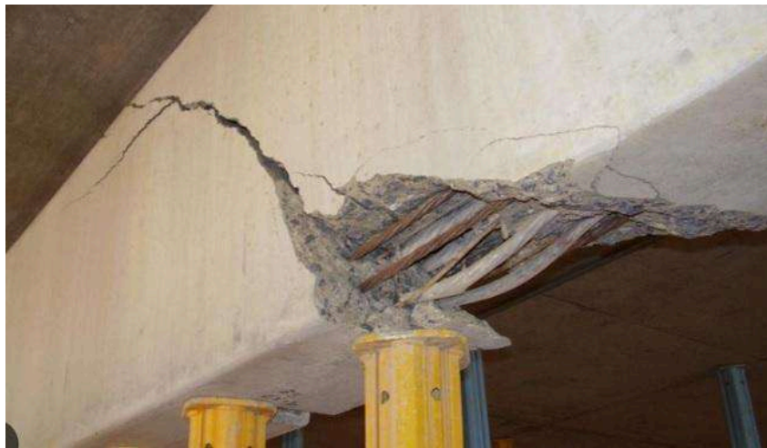
Şekil 3.1.3 Betonarme kirişlerde deprem etkisiyle oluşan aşırı sehim ve kalıcı deformasyon.
