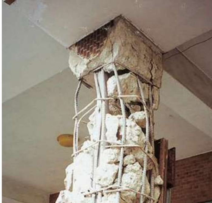
Şekil 3.1.1 Betonarme elemanda çekirdek betonun dağılması ve taşıyıcı kapasitenin tamamen kaybolması.
