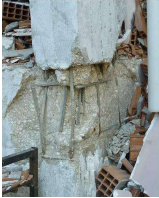
Şekil 2.8.3 Yetersiz Etriye Aralığından dolayı hasar alan bir kolon
