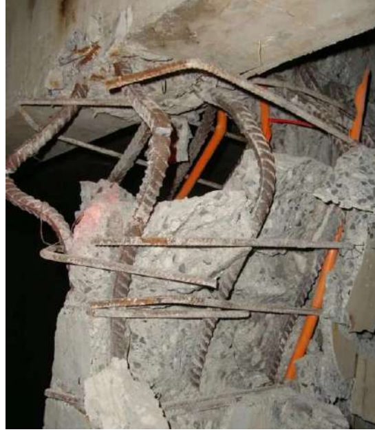
Şekil 3.1.2 Deprem etkisi altında etriye kancalarının açılması ve sargılama etkisinin kaybolması.
