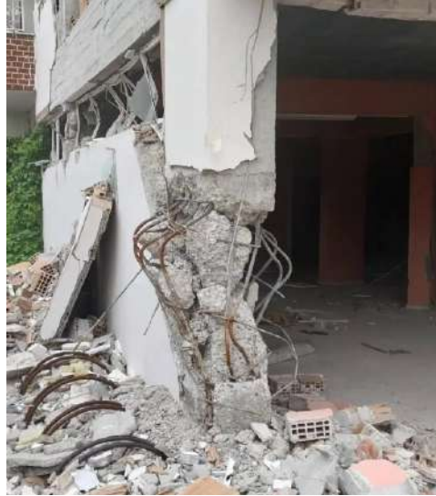
Şekil 2.9.3 Deprem etkisi altında betonarme çerçevede kolonlarda sargılama kaybı ve burkulma hasarı.
