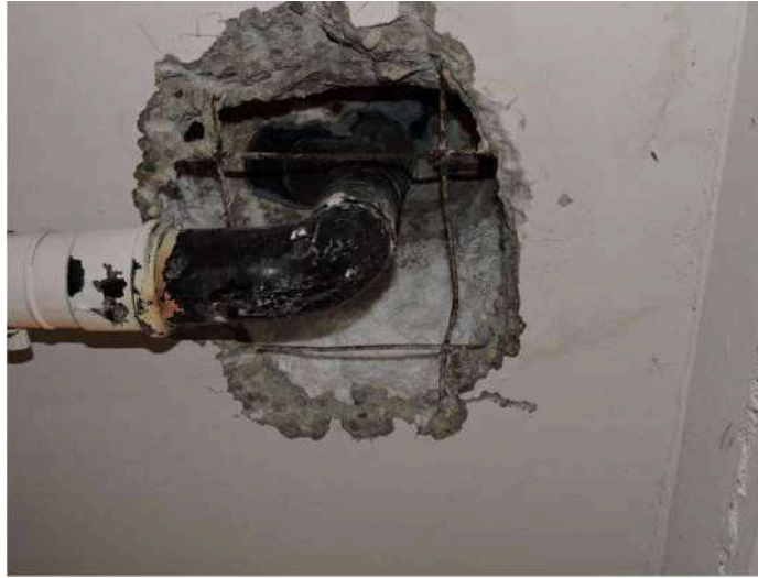
Şekil 2.8.9 Perde beton taşıyıcı eleman içinde kontrolsüz açılan tesisat geçişleri.
