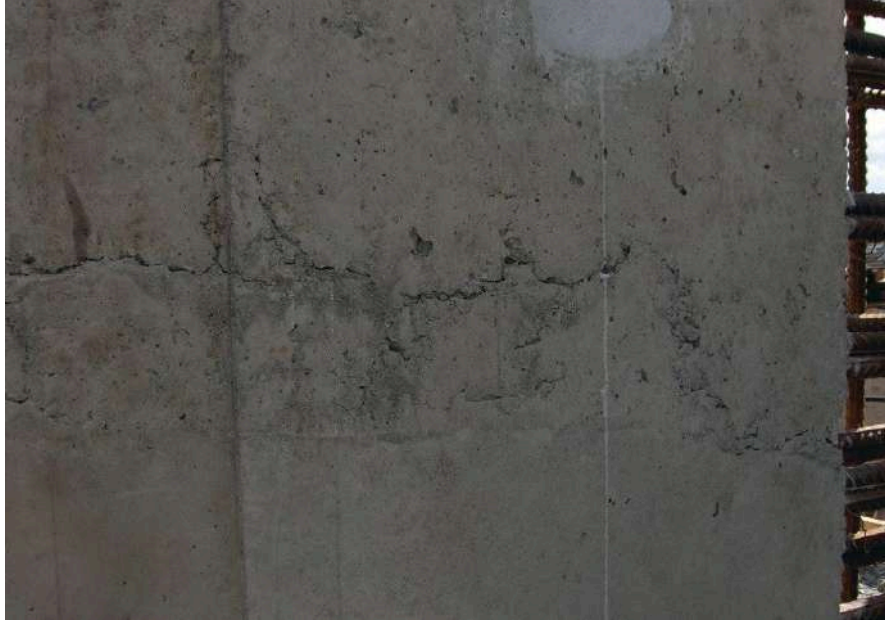
Şekil 2.8.9 Aderans zayıflığı nedeniyle derz hattı boyunca oluşan ayrılma ve çatlak gelişimi
